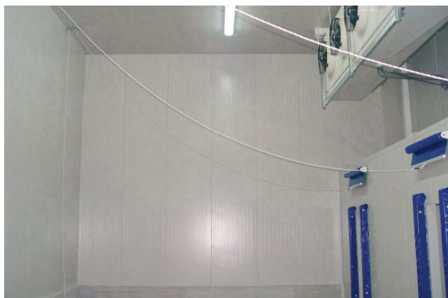
Cámara frigorífica realizada con paneles Isofrigo.
