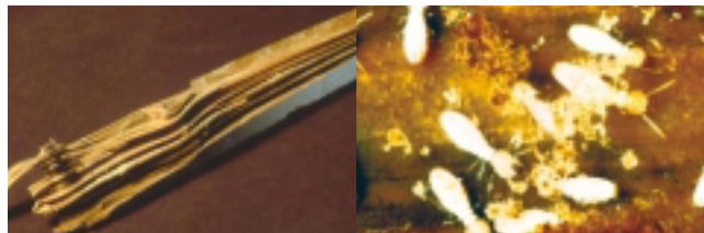
Madera afectada por termitas
