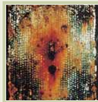
SIN GALVANIZAR: la herida se ha profundizado y la corrosión (huellas rojas) se extiende más allá de la entalladura.
