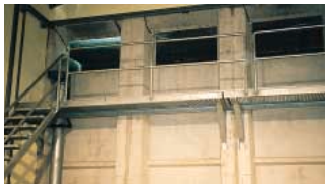
Acceso desde cámara de válvulas al interior del depósito.
