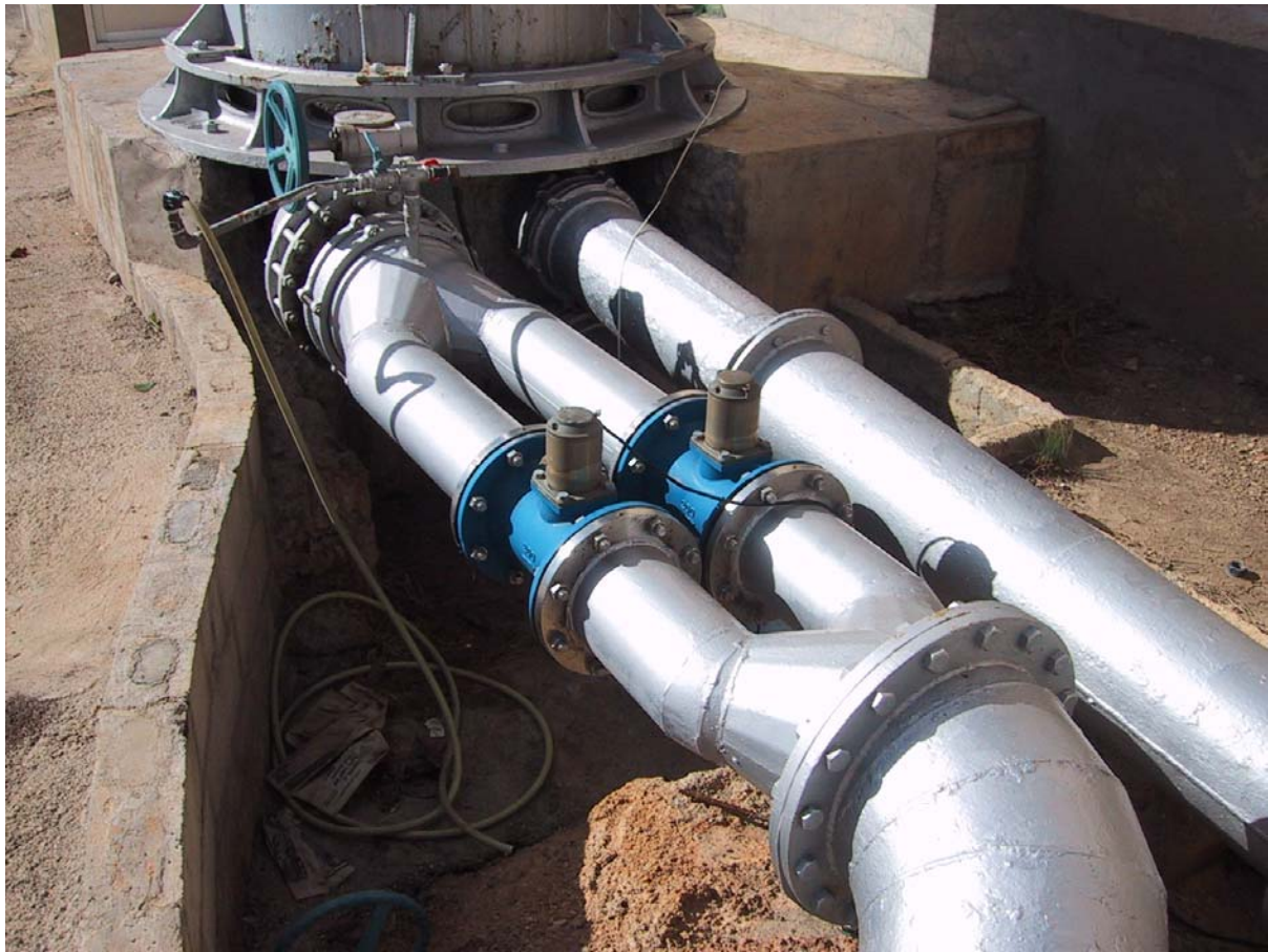
Dos contadores de control de salida de acuífero ( 200 mm. ) leídos a través de línea telefónica.
