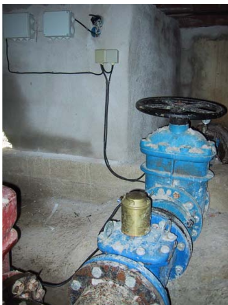
Contador de entrada de una ciudad, situado a 25 Km. de la misma y leído desde la empresa gestora a través de línea telefónica.
