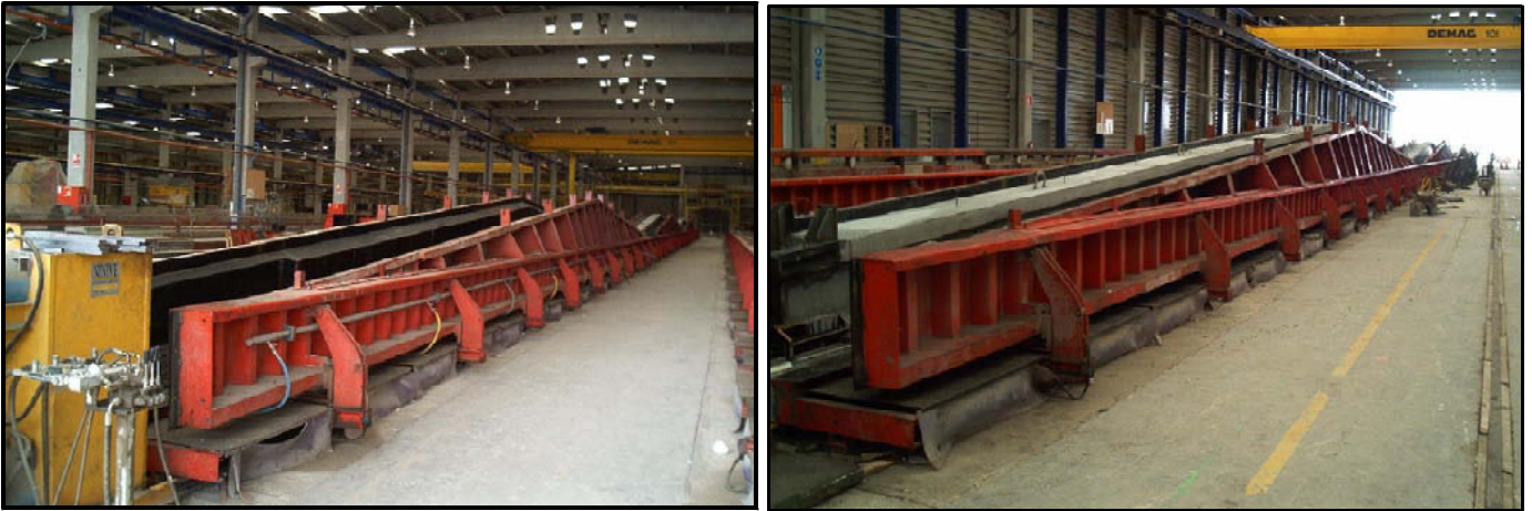
Lineas de pretensado en el interior de las instalaciones de la fábrica. Se observan colocados los moldes de vigas Delta 7%.
