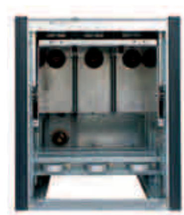
Compartimento de cables (acceso frontal)
