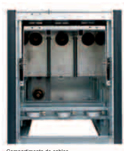
Compartimento de cables
