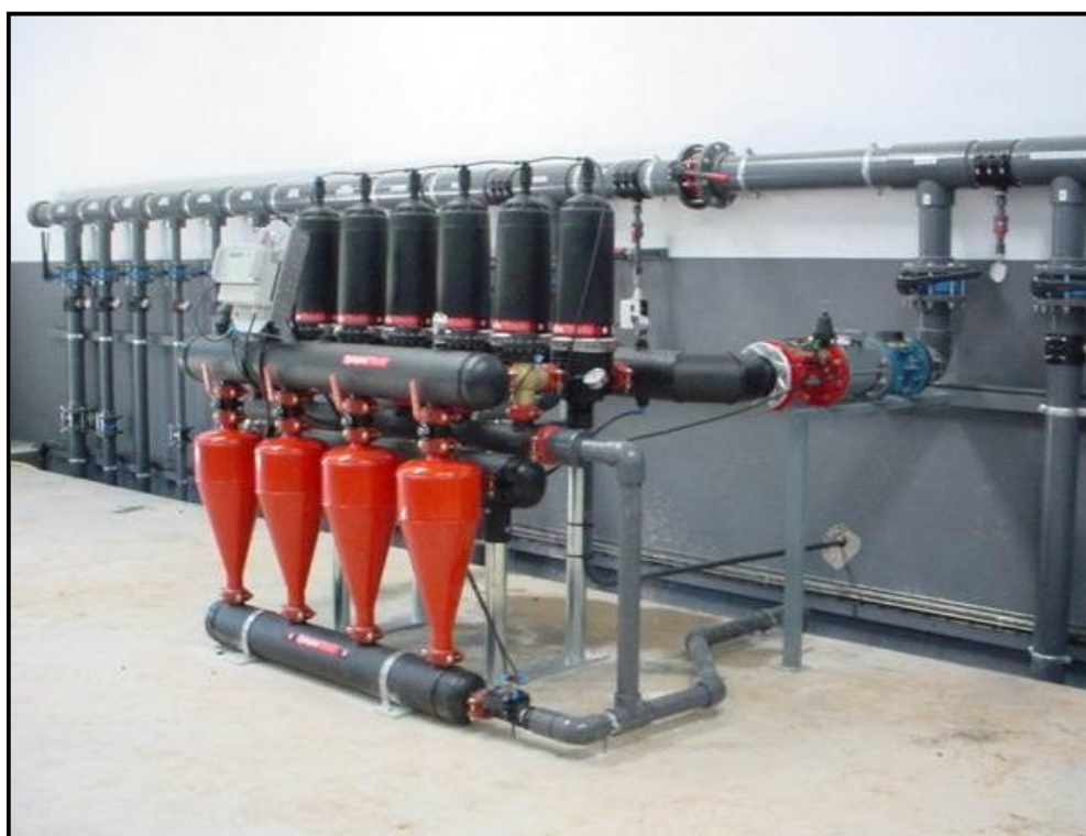
Fig. 6.- Instalación con Colectores de Polietileno en cabezal de fertirrigación
