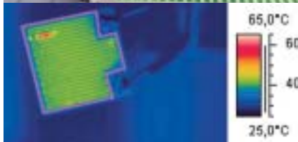
Imagen IR de un reostato defectuoso
