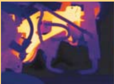
Puntos calientes en robots de soldadura
