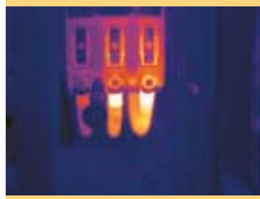
Corrosión en conexiones
