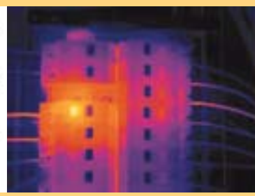
Fallos en ruptores internos
