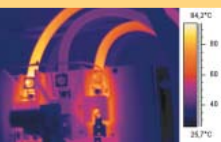
Mala conexión y daños internos
