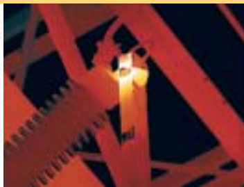
Conexiones mal fijadas
