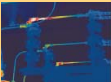
Oxidación de los conmutadores de alta tensión
