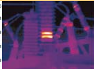
Defectos en aislantes
