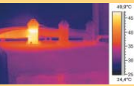
Conexiones de cables sueltas
