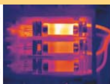
Daños en fusibles internos
