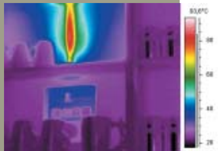
Calentador de gas construido muy cerca de la pared constituye un riesgo de incendio
