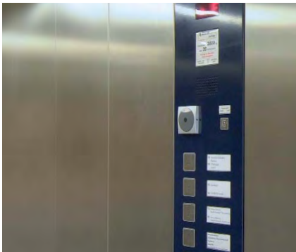
Integración con el uso del ascensor
