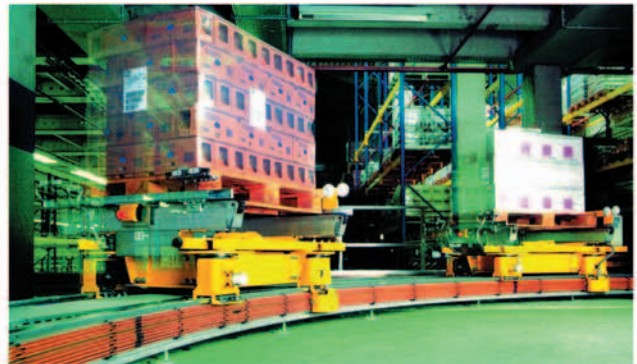
Unidad de manutención en una instalación de almacenaje
