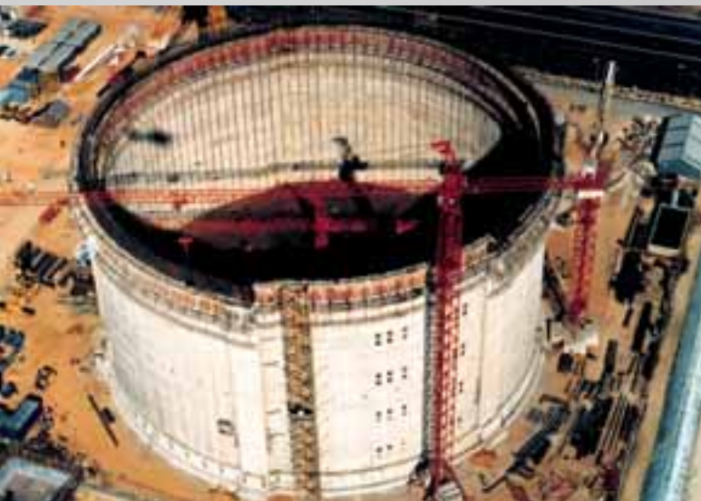
Tanques criogénicos · LNG Tanks
