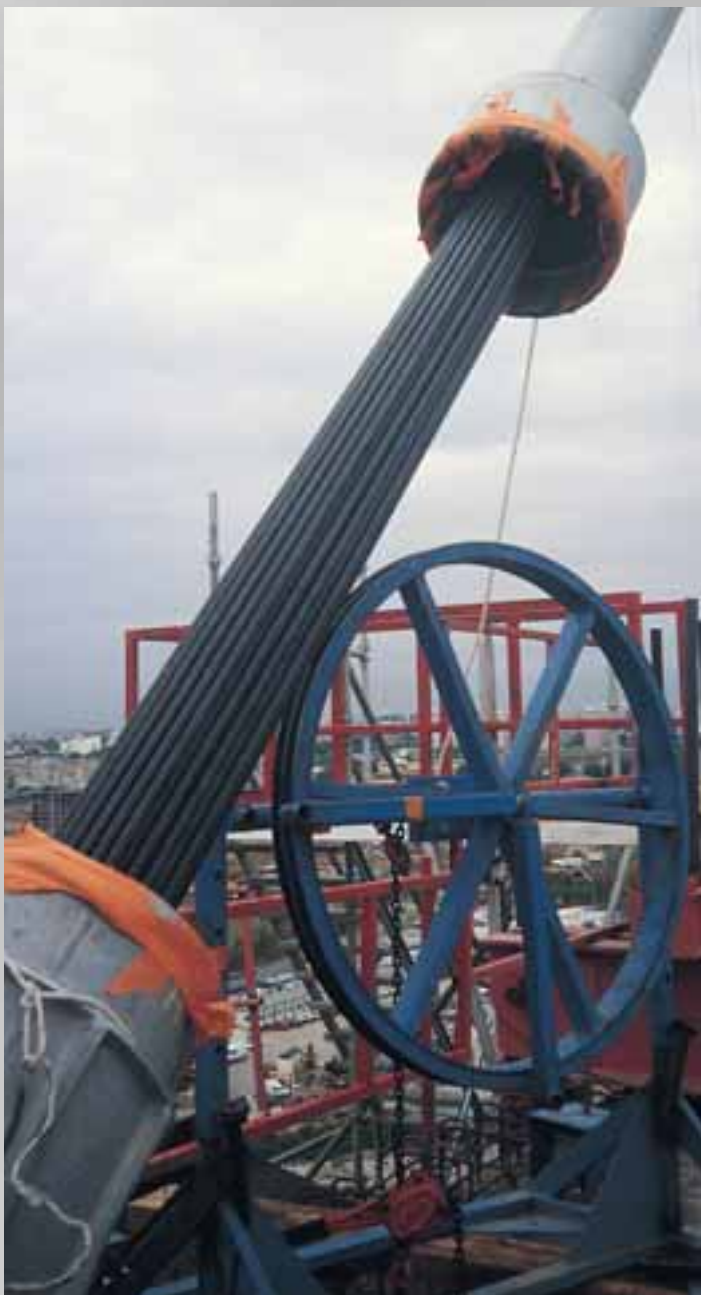
Instalación de cordón para puente atirantado · Strand installation for cable stay bridge
