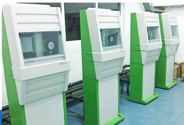
Instalación de Dosificación de Cloro Gas
