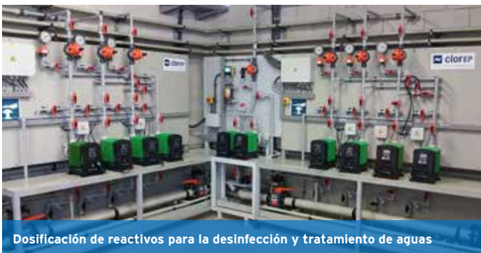
Instalaciones de Electrocloración Salina
