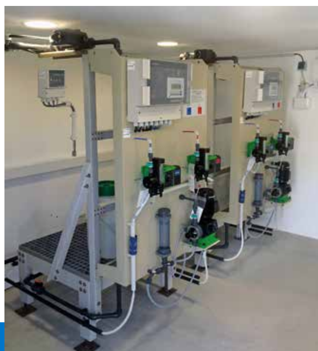
Generadores de Dióxido de Cloro
