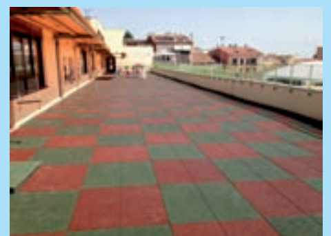
Terrassa de llar d'infants executada amb paviment de llosetes de cautxú d'exterior per a zones de jocs infantils
