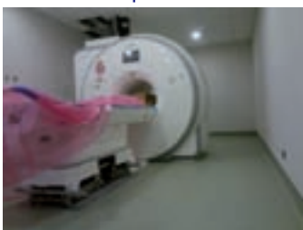
Vescom a parets i terra amb Paviment Vinílic Conductiu, remontat en mitja canya. Sala TAC d'hospital.
