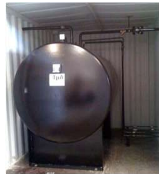
Almacenamiento de combustible
