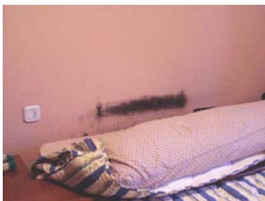
Este es un ejemplo de humedad de condensación continuada cerca de una cama.
