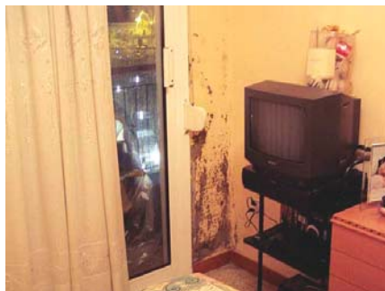
Este es un ejemplo de humedad de condensación continuada cerca de una ventana.
