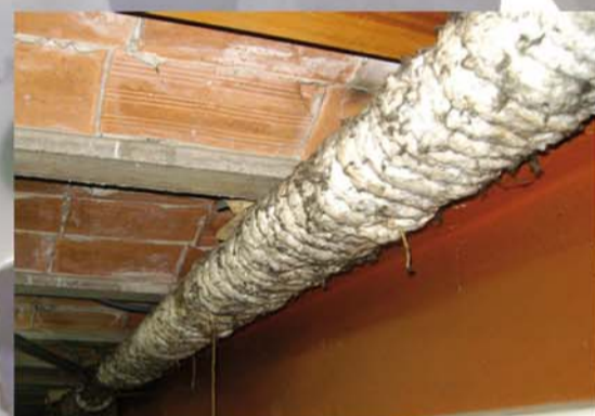
λ Amianto friable usado como aislante de tuberías en calefacción
