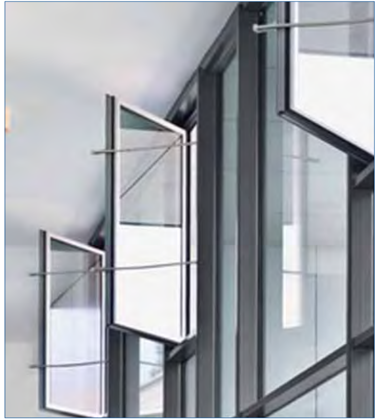
SISTEMAS DE VENTILACIÓN
