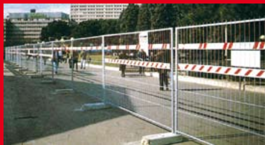
VALLAS DE CERRAMIENTO
