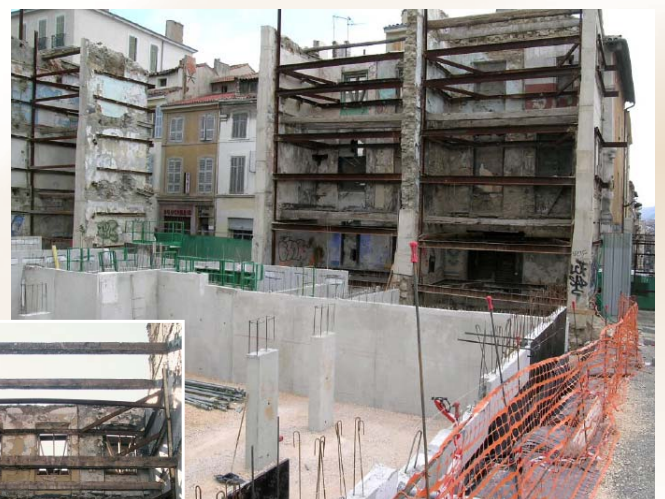
El tratamiento se realiza bajo la fachada antigua hasta la profundidad prevista de los cimientos de la parte nueva.
