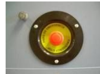
Seta de paro de emergencia
