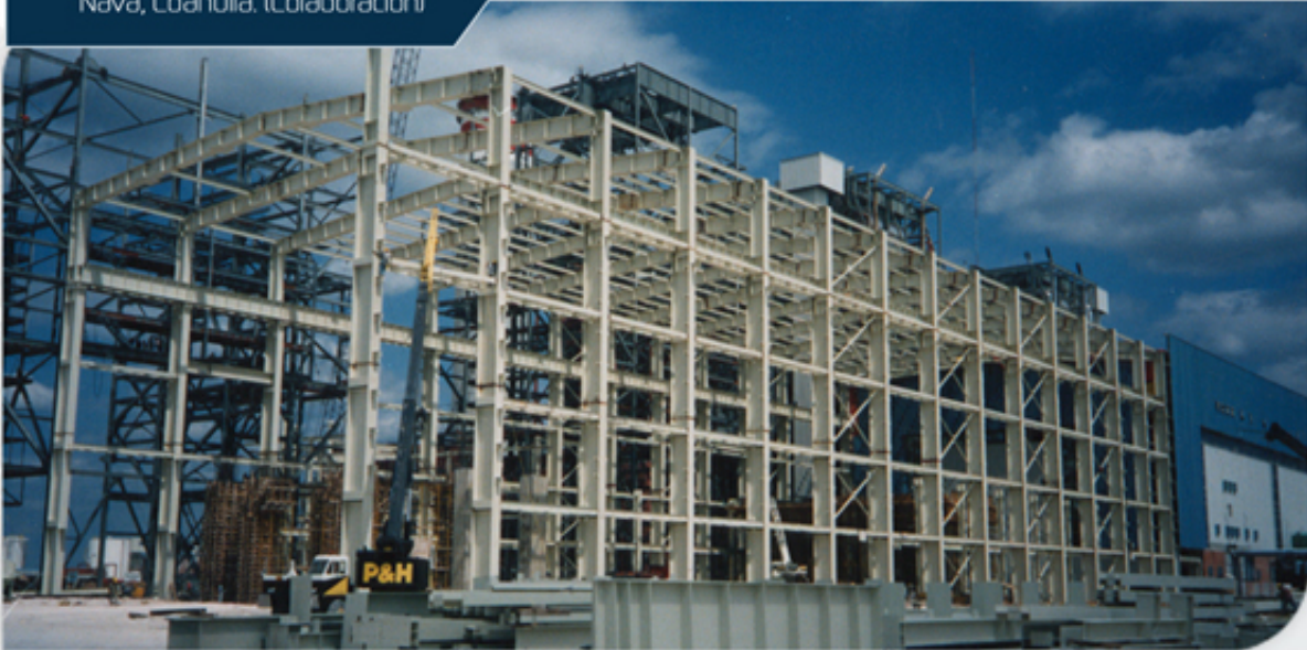
Proyecto: Casa de máquinas Nava, Coahuila. (Colaboración)
