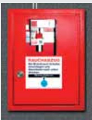
Cuadro de control para activación manual
