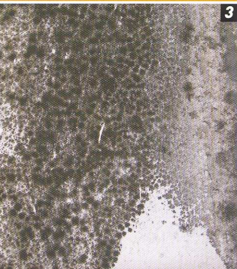
3. Dettaglio di parete esterna con muffa
