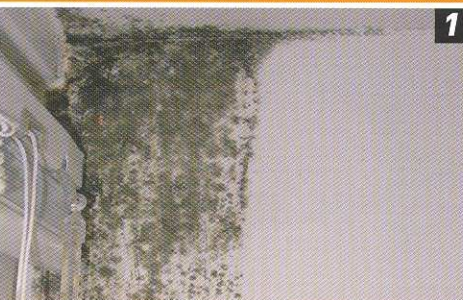
1. Parete interna con muffa
