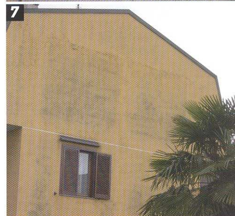
6-7. Esempi di pareti deturpate a causa dell'attacco di alghe e muffe
