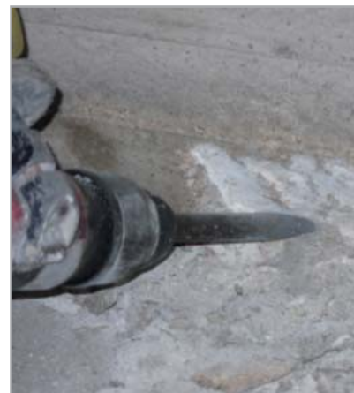
Fig. 8.1a - Fasi della sigillatura di una ripresa di getto: demolizione meccanica intorno alla ripresa di getto per una profondità di circa 6 cm
