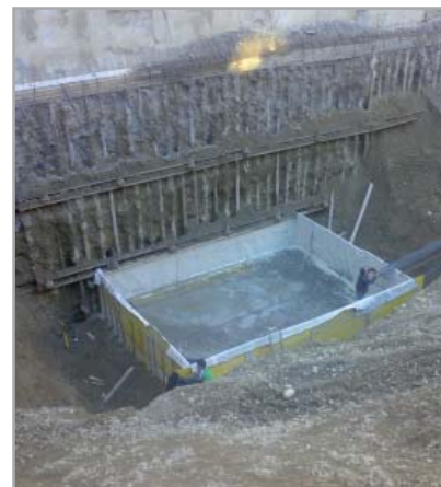
Fig. 7.4 - Impermeabilizzazione del basamento di una gru a torre mediante teli bentonitici MAPEPROOF
