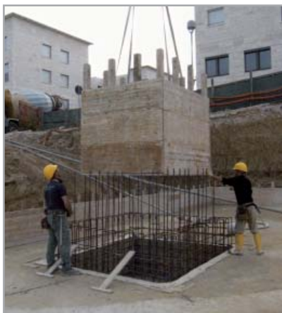
Fig. 7.5e - Posizionamento dei casseri in legno previa sigillatura della ripresa di getto tra platea e pareti con IDROSTOP B25
