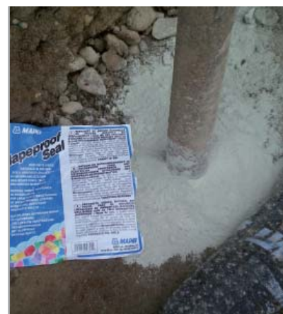
Fig. 7.60a - Fasi della sigillatura di una tubazione passante la platea: applicazione di MAPEPROOF SEAL attorno la tubazione passante
