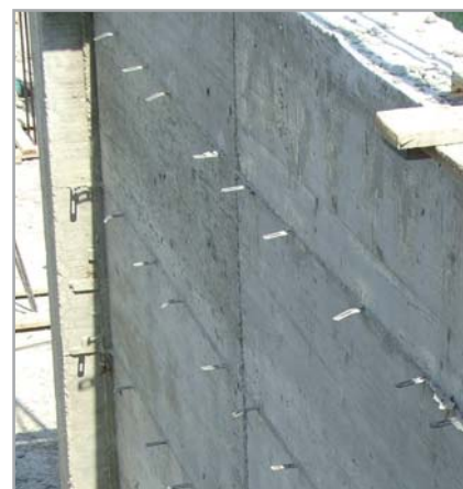
Fig. 7.43 - Lame di cassero sporgenti dalla parete in c.a. prima della rimozione delle stesse
