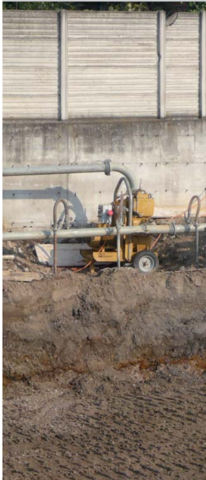
Fig. 3.7 - Pompa autoadescante utilizzata nel sistema wellpoint
