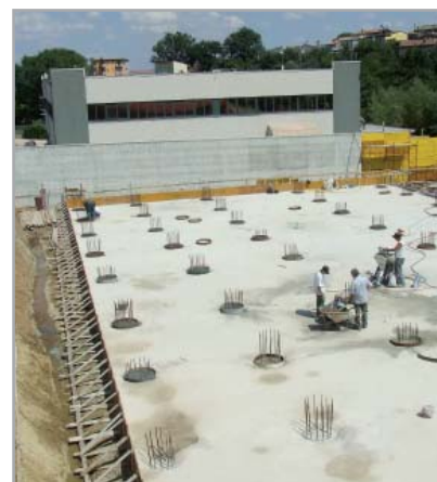
Fig. 7.18 - Visione d'insieme di una serie di pali nella fase di ricostruzione della testa di ciascuno
