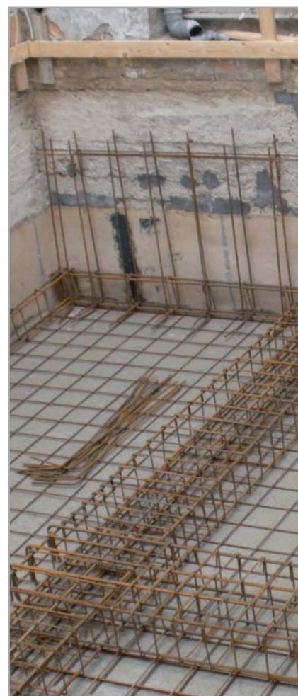
Fig. 8.5b - Dopo aver posato il telo anche sull'orizzontale, vengono posate le armature per il getto della soletta e delle contropareti in c.a.
