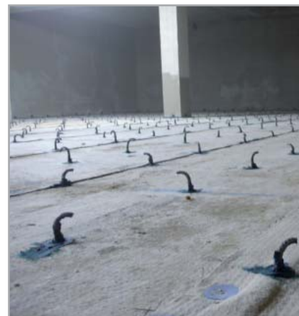
Fig. 8.6g - Connettori metallici stuccati prima del posizionamento delle armature della nuova soletta da realizzare
