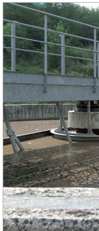
Fig. 7.64 - Vasca di sedimentazione in avanzato stato di degrado
