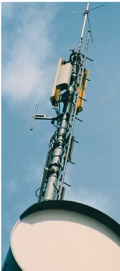
Instalación de componentes eléctricos en el pegado de la cubierta a los elementos base de las antenas GSM.
