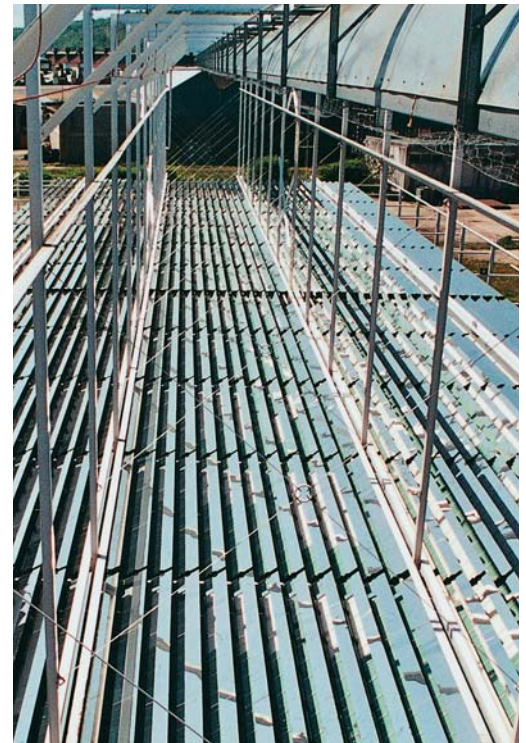
Pegado de espejos a la estructura mecánica de una planta solar térmica.
