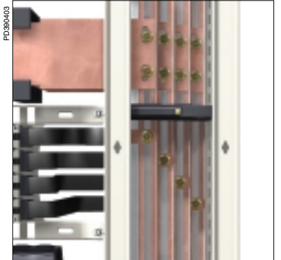
Es posible acceder directamente a todos los puntos de conexión desde la parte frontal del cuadro.
