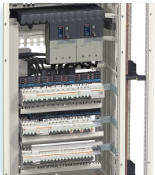
Añadido de aparamenta en reserva o modificación de aparamenta con repartidor Multiclip.
