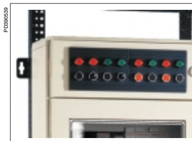
Pilotos + pulsadores diámetro 22 mm, en puerta parcial.
