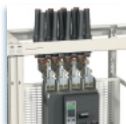
Conexión superior por cables.
