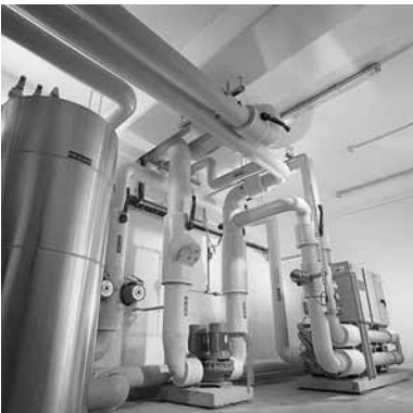
Aplicación de bombeo
