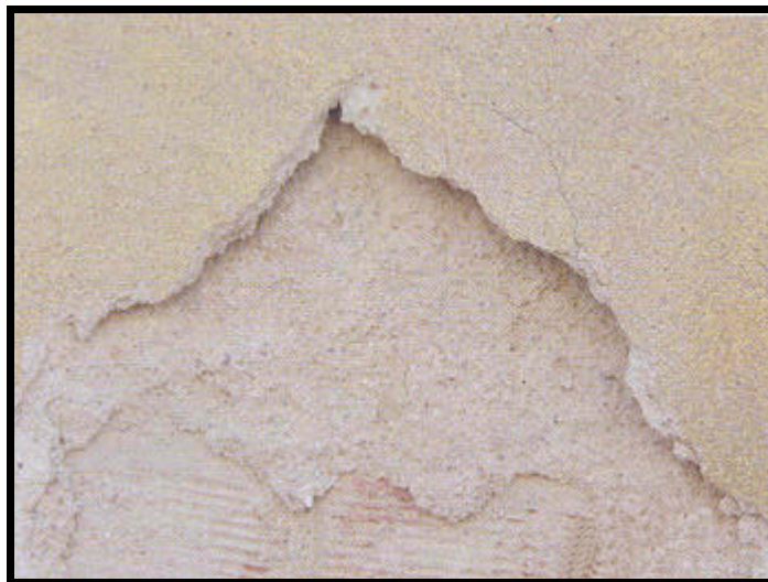
Fig.1.- Desprendimiento del revestimiento debido a eflorescencias.
